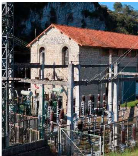
Figuras 9 y 10: Central de Herrerías: tubería a presión sobre el Nansa (Red de Patrimonio Industrial de Cantabria) y vista de la central y su parque de transformación (LVC, 2025).
