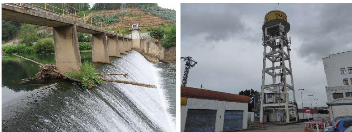
Figuras 15 y 16: Presa de hormigón armado sobre el Saja, al este de Puente San Miguel, para la factoría Sniace en Ganzo - Torrelavega (LVC). Depósito elevado de agua de la antigua fábrica de neumáticos de Torrelavega (LVC).
