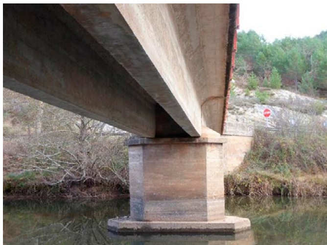
Puente de Quintanilla de An: Detalle del apoyo de sus dos vigas en la pila central (LVC).
