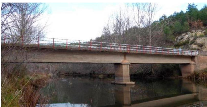
Puente de Quintanilla de An (Valderredible) sobre el río Ebro: Vista general del puente de hormigón armado (LVC)
