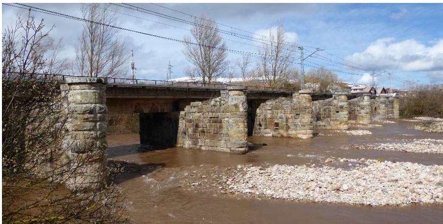
Puente ferroviario sobre el río Híjar entre Matamorosa y Reinosa: Sus pilas, de fábrica pétreo, son de 1857 y su tablero, con vigas de hormigón armado, es de 1942 (LVC).
