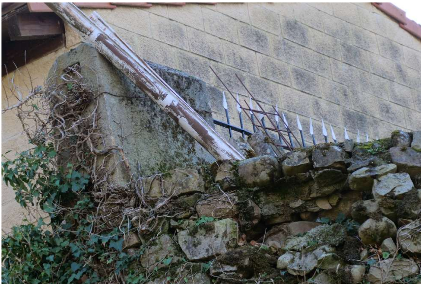
Figura 11. Murete del pretil y en su frente se aprecia el mechinal donde apoyaba la barandilla de madera del puente (V. Cassi).
