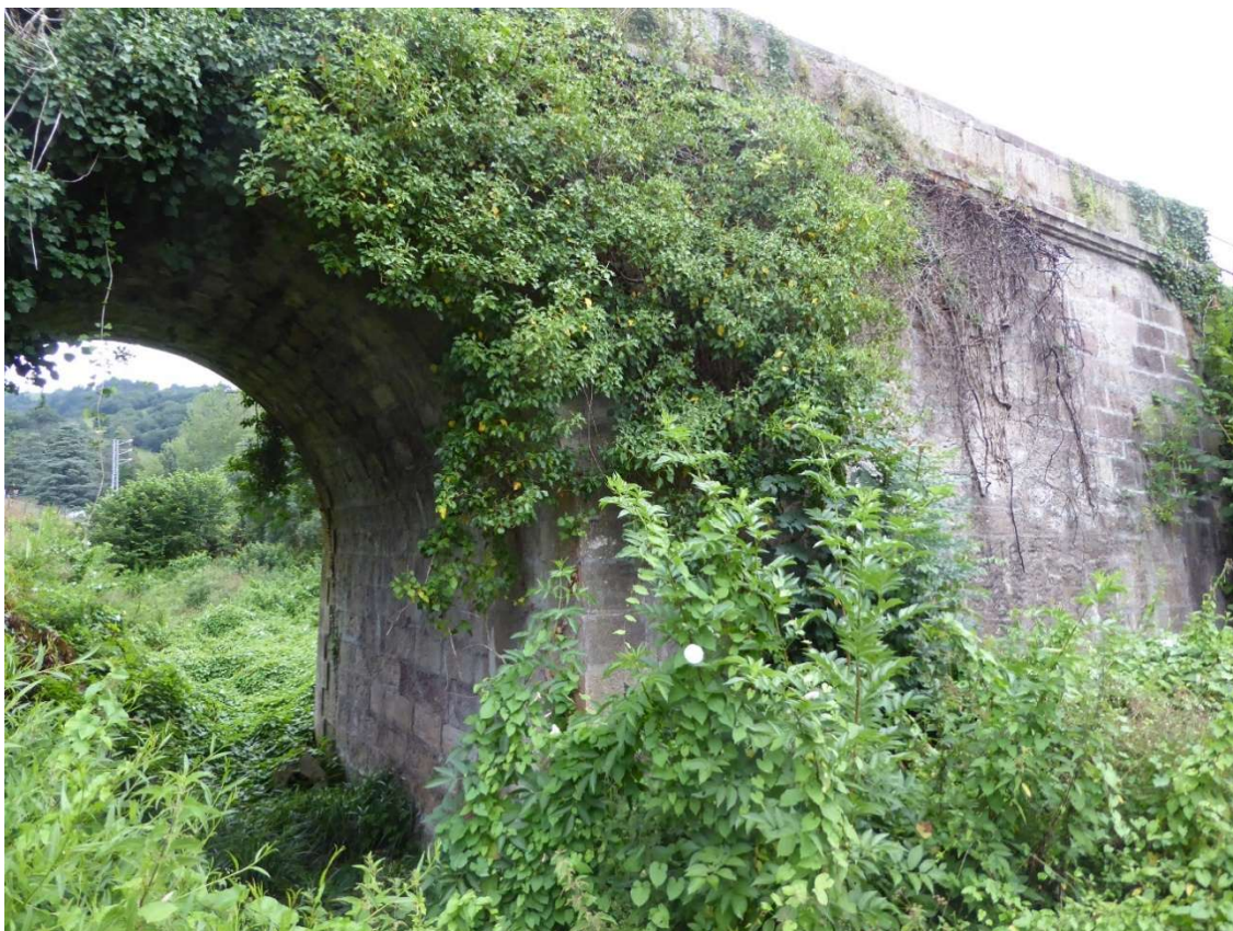
Figura 20. Bóveda de menor vano del puente de Arenas de Iguña. Debiera retirarse la vegetación (LVC).
