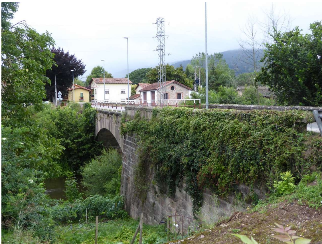
Figura 21. Fachada sur del puente de Arenas y bóveda principal. Debiera retirarse la vegetación (LVC).
